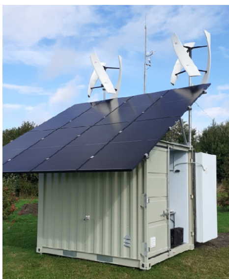
1. att. Spēkstacijas saules paneļu novietojums
